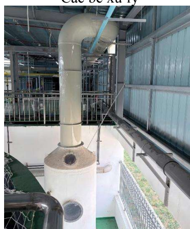
Hệ thống xử lý mùi hôi
