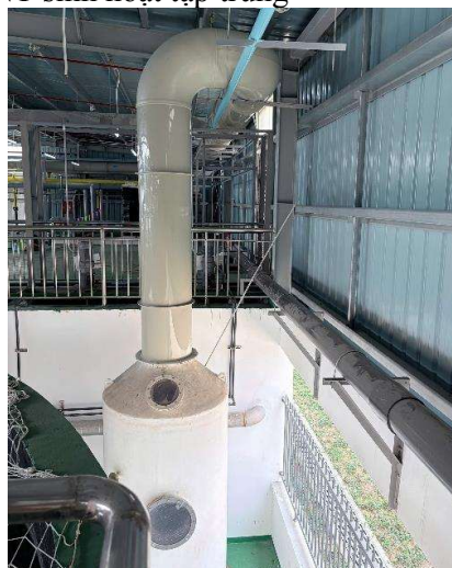
Hệ thống xử lý hút mùi
