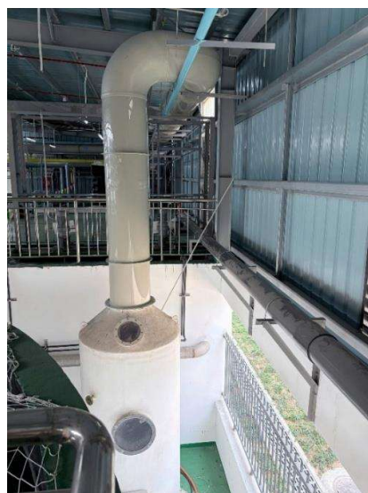
Hệ thống xử lý hút mùi trạm XLNT sản xuất
