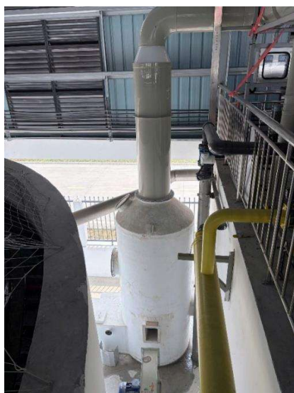
Hệ thống xử lý hút mùi trạm XLNT sinh hoạt tập trung
